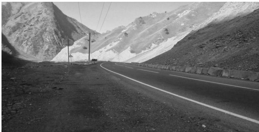
Рис. 1. Типичные осыпные явления верхнего откоса на участке Транскама.
