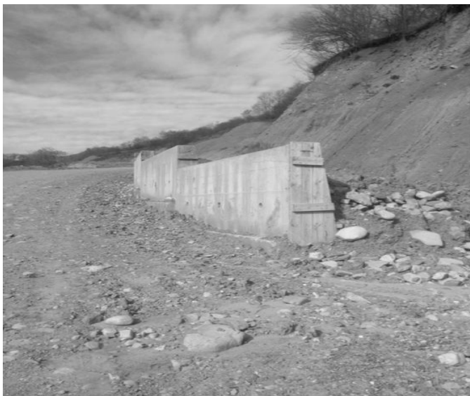
Рис. 2. Подпорные стены на скальных выемках, построенные без соответствующего анализа.
